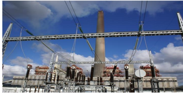
Central Térmica de Endesa en As Pontes
