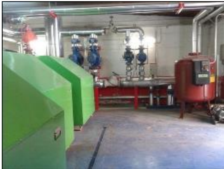
Figura 5. Sala de calderas existente de gas natural (Fase 2)
