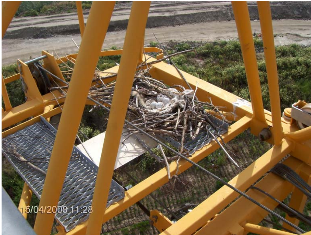
Figura 4. Nidificación en torre grúa
