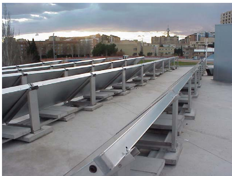
Figura 6.- Ejemplo de instalación de paneles solares con contrapesos
